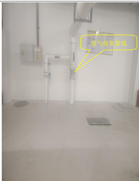
污水处理站废气收集管线
