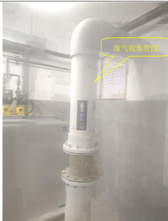
污水处理站废气收集管线
