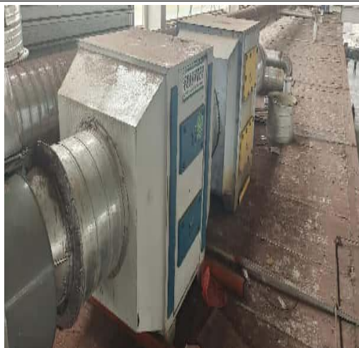
DA006 固化工序二级活性炭吸附装置
