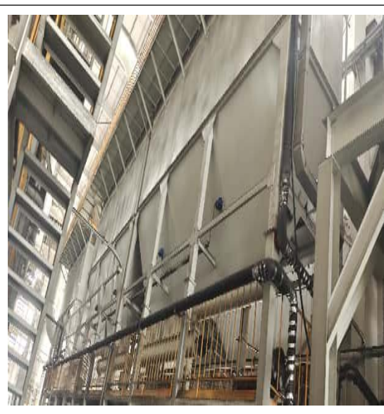
DA004 布袋除尘器 4
