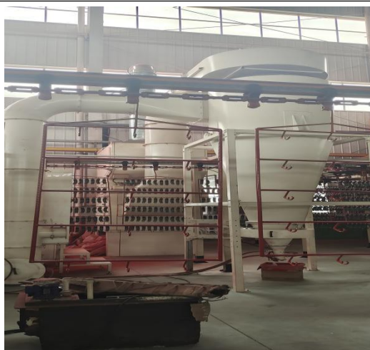
DA006 喷塑工序旋风除尘 4+布袋除尘器 6
