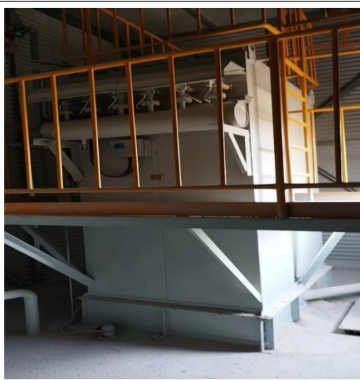
膨润土储罐仓顶除尘器
