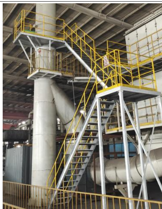
排气筒 DA005 采样平台及爬梯
