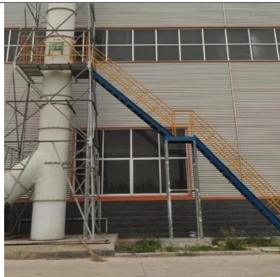
排气筒 DA002 采样平台及爬梯
