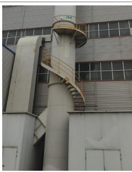
排气筒 DA004 采样平台及爬梯
