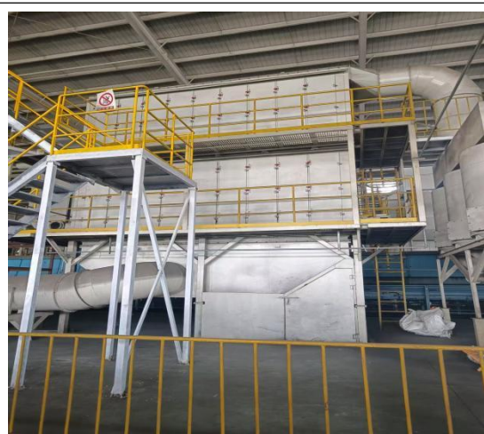
DA005 布袋除尘器 5
