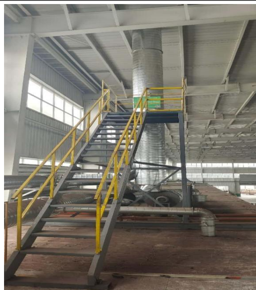
排气筒 DA006 采样平台及爬梯
