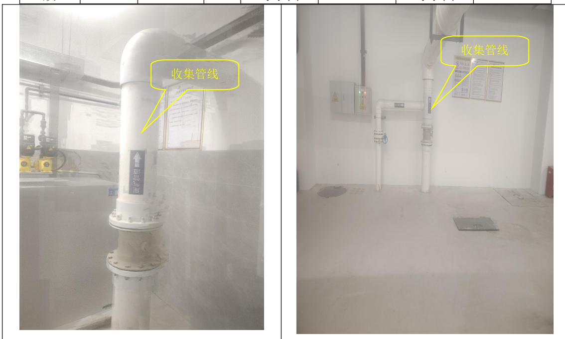
污水处理站废气收集管线
