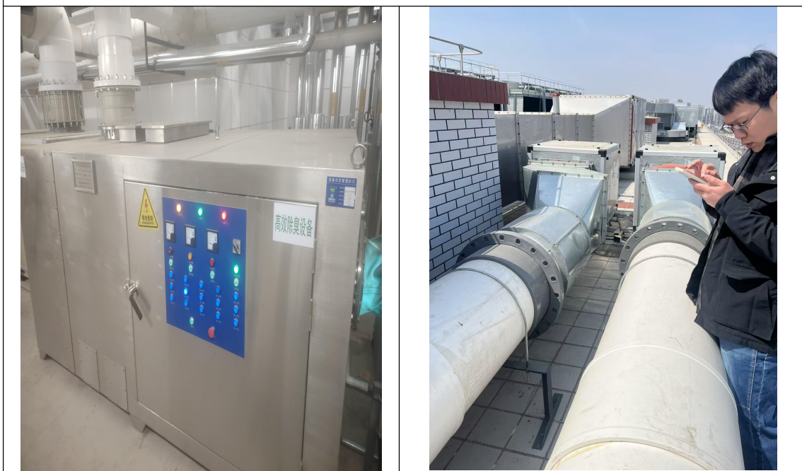
污水处理站废气处理设施
